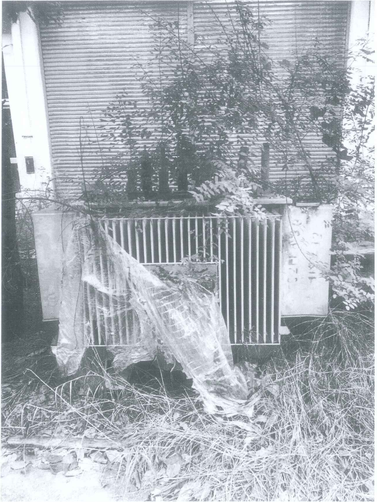
หม้อแปลงไฟฟ้าประกอบอาคาร
